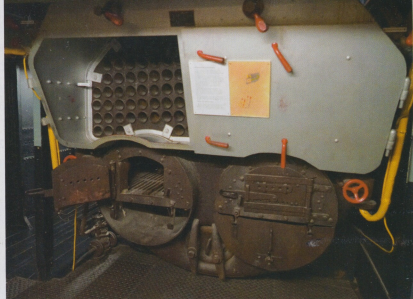
Teilgeöffnete Heizwand vom Kessel zeigt die Siederöhre; darunter oben die beiden Feuerklappen und darunter der Aschefall
