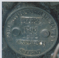
Fabricschild Baujahr 1931; zulässige Dampfspannung 12 bar; Kessel-Nummer 2173 neben der Feuerlochtür; zu deren Bedienung dient die Kette.
