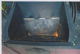
Blick in die geöffnete Vorrostfeuerung zum Freitag-Feierabend.
