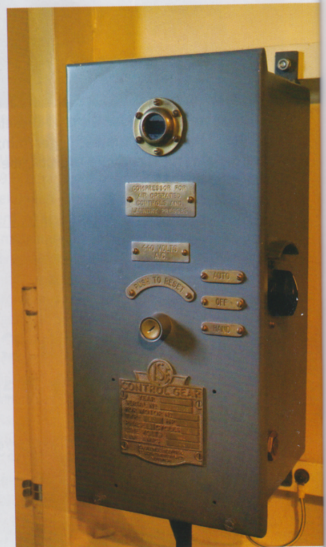
Schaltkasten für Luftkompressor der Wäscherei bzw. Luftsteuerungen; Baujahr 1958, 440 V, 3 PS
