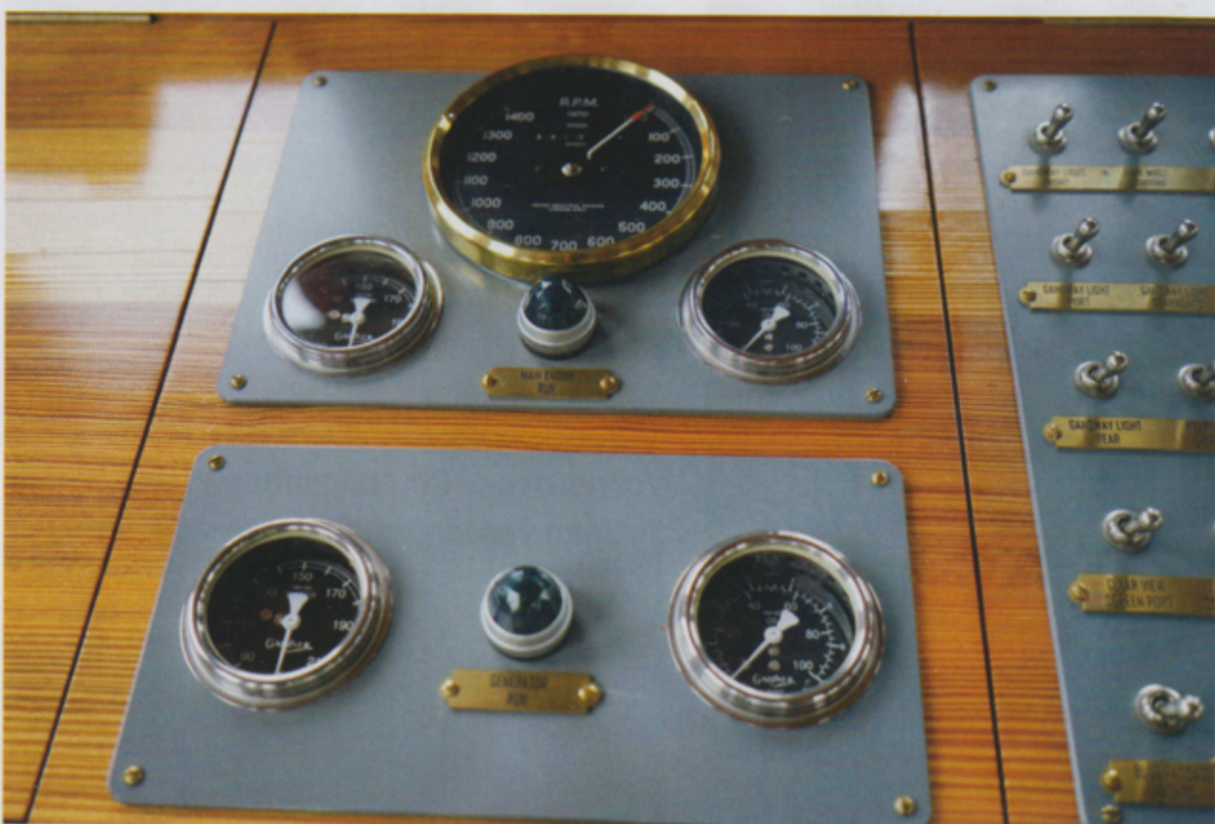
Armaturenbrett der beiden Gardner-Dieselmotoren: Oben Schraubenantrieb mit Nenndrehzahl 700 Umdrehungen/min; darunter jeweils links die Kühlwassertemperatur rechts der Öldruck; die unteren Armaturen sind für den Stromgenerator
