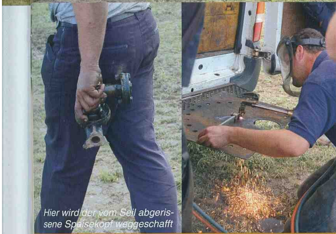
Fachmännische Begutachtung der abgerissenen Speiseleitung
