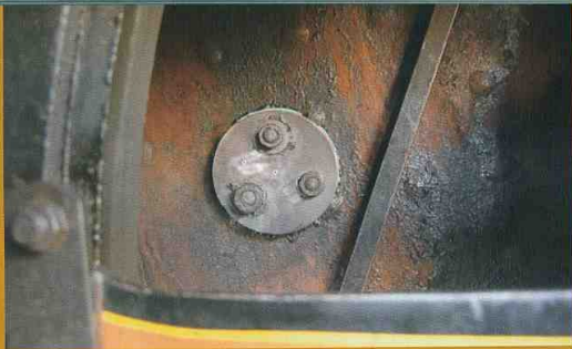
Sauberkeit der Reparatur, der größere ersetzt den ehemals wohl ausgerissenen kleineren Bolzen
